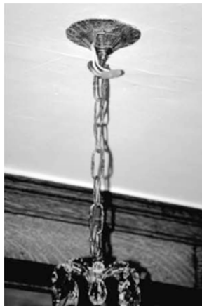
Figura 4. El cableado eléctrico expuesto de esta lámpara no cumple con los códigos eléctricos.
