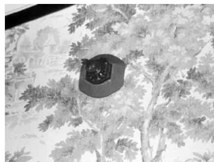
Figura 6. Rociador instalado de manera tal que se mimetice con las terminaciones arquitectónicas de madera.
