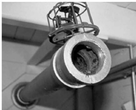
Figura 1. Sedimento en un sistema de red seca. Observe la jaula de alambre que protege el rociador situado sobre la cañería.
