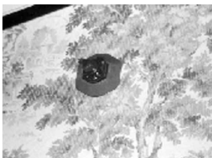
Figura 3. Rociador colocado sobre un muro.
