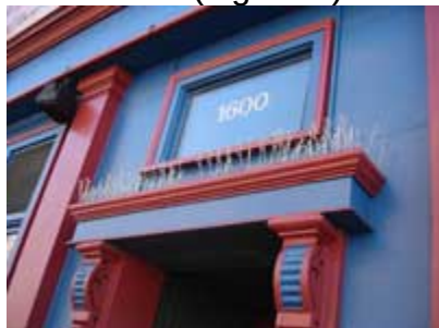
Figura 5. Las púas ahuyenta aves colocadas en este edificio patrimonial protegen de la suciedad a los clientes/visitantes y a la estructura.
