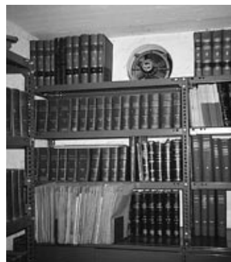
Extractor de aire en depósito de Biblioteca de Schoenstatt.
