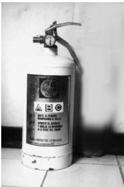
Extintores cargados y en buenas condiciones
