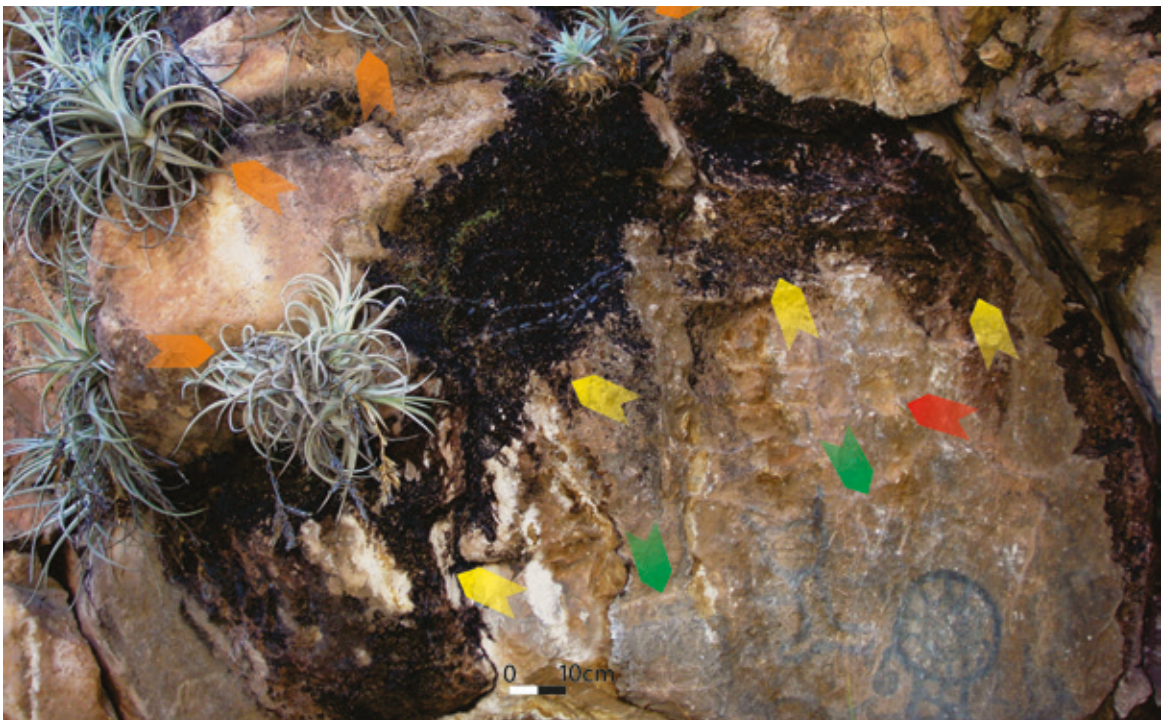
Figura 7. Detalle de UT3 con presencia de microorganismos (flechas amarillas), Bromeliaceae (flechas naranjas), graffiti (flechas verdes) y desprendimiento subcircular (flecha roja) (Fotografía: Rodríguez Curletto, S. 2008). Detail of the UT3 with presence of microorganisms (yellow arrows), Bromeliaceae (orange arrows), graffiti (green arrows) and subcircular detachment (red arrow) (Photograph: Rodríguez Curletto, S. 2008). Detalhe do UT3 com presença de microrganismos (setas amarelas), Bromeliaceae (setas laranjas), grafite (setas verdes) e descolamento subcircular (seta vermelha) (Fotografia: Rodríguez Curletto, S. 2008).
