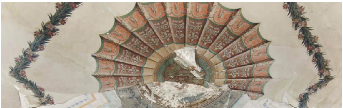
Figura 3. Papeles pintados de la sala II, cuyo motivo principal es un rosetón en forma de sombrilla china. Se observa la superposición de elementos decorativos correspondientes a épocas y gustos distintos (Fotografía: Abelleira, S. 2008). Wallpapers in room number II, with a central rosace in a chinese sunshade style as the main decorative element. An overlapping of decorations from different periods and trends is visible (Photograph: Abelleira, S. 2008).
