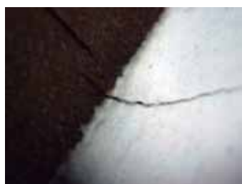
Foto 11: Fisura de la base de preparación debida a la fractura de la madera.
